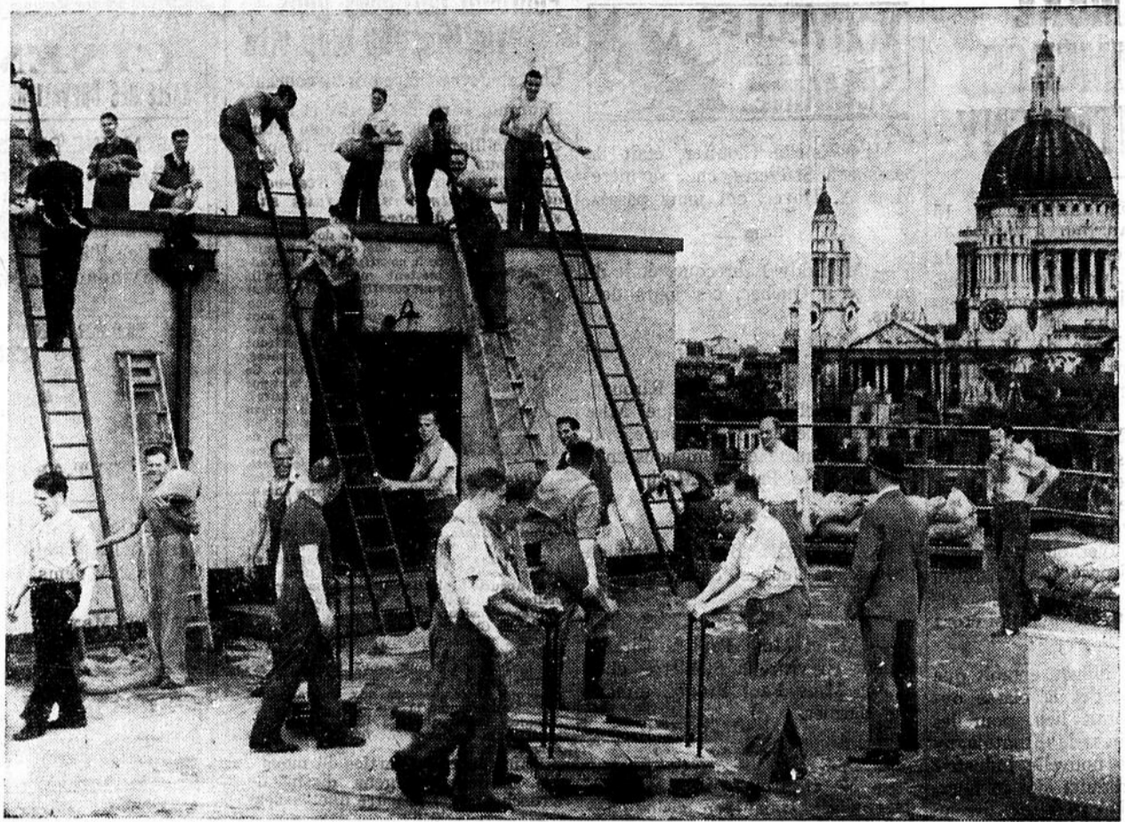
● Des muscles seront endoloris. — Pour ces travailleurs au collet blanc, leurs muscles seront sensibles après qu'ils auront terminé la mise en place des sacs de sable destinés à protéger l'édifice de leurs bureaux, où ils travaillent.
