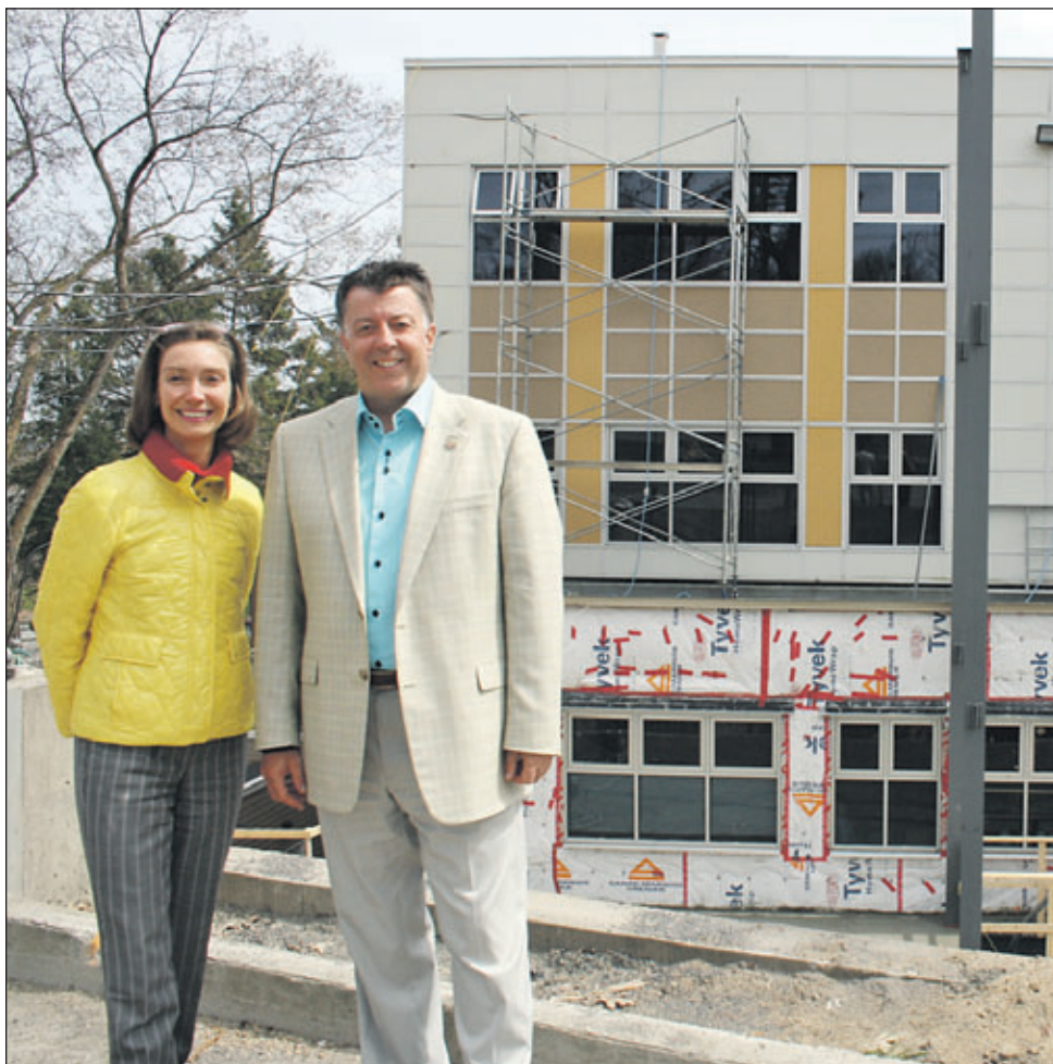
Mme Marie-Josée Martineau, directrice adjointe et M. Alain Roy, directeur de l'externat Saint-Jean-Berchmans devant les travaux d'agrandissement.
