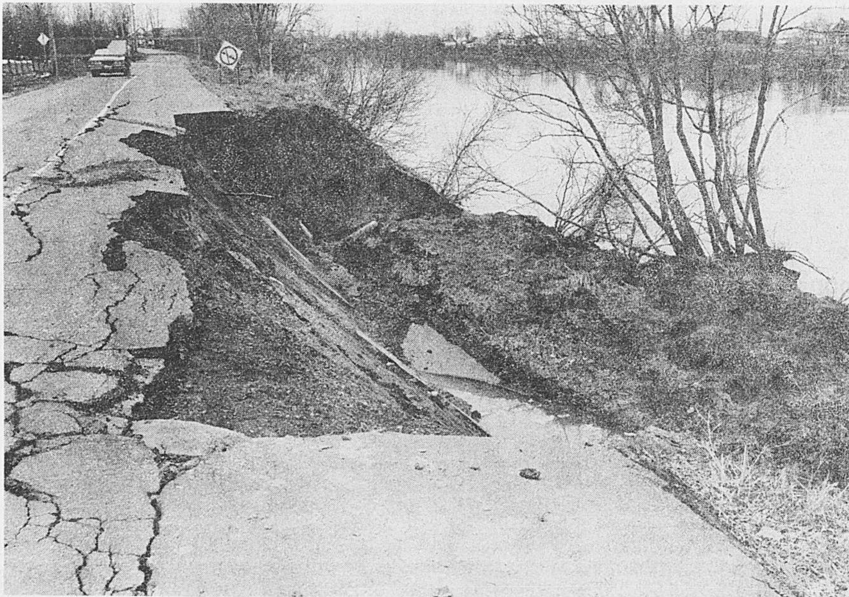
Le boulevard L'Assomption, qui longe la partie sud de la rivière du même nom, est fermé depuis mercredi, entre la rue Valmont et le boulevard Industriel, à Repentigny, à la suite de l'affaissement de la route sur une cinquantaine de pieds de longueur et une vingtaine de pieds de largeur. C'est la rivière l'Assomption qui est à l'origine de l'érosion de cette voie provinciale qui conduit à Lavallée, connue sous le nom de "chemin de la petite Assomption sud".
