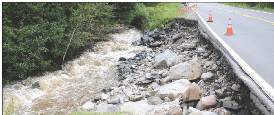
Frampton : L'eau a fragilisé plusieurs accotements de route, dont la 216 à Frampton.
