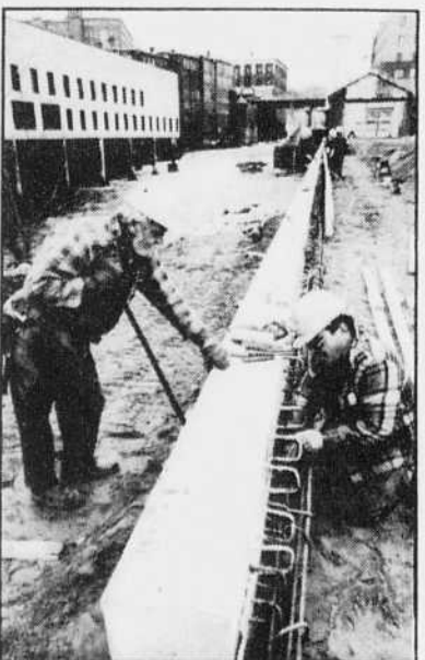
La centrale hydroélectrique Abénaquis, sur la rivière Magog au cœur du vieux centre-ville de Sherbrooke, fait l'objet d'importants travaux de réfection qui se prolongeront jusqu'à la fin de 1991.
