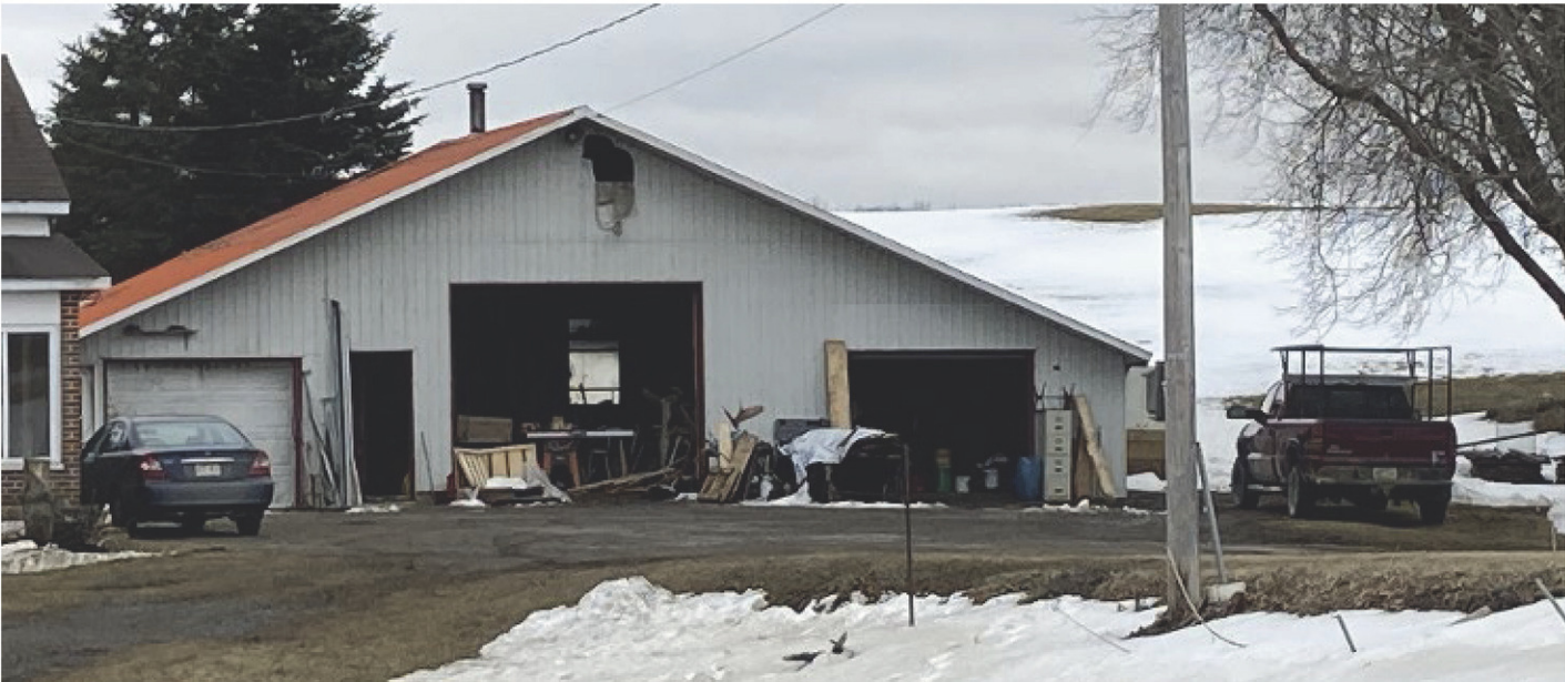
Le bâtiment tient toujours debout, mais les dommages sont importants. (Photo www.lanouvelle.net)
