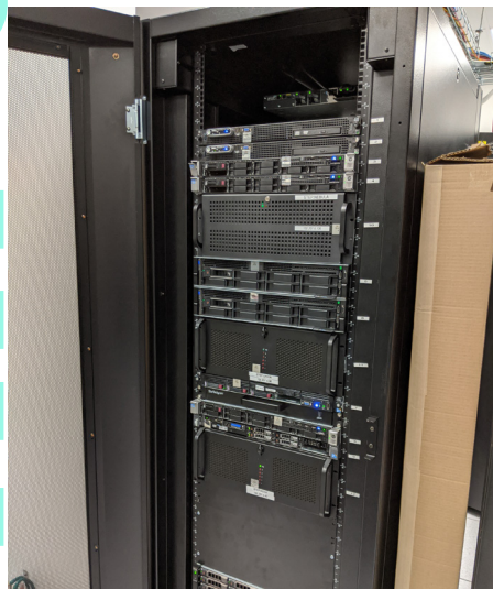
Serveurs du STEP
