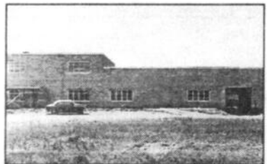
Troisième usine en construction de la compagnie Laurentide, située sur la 12e Avenue à Shawinigan-Sud. Source: Ville de Shawinigan-Sud
