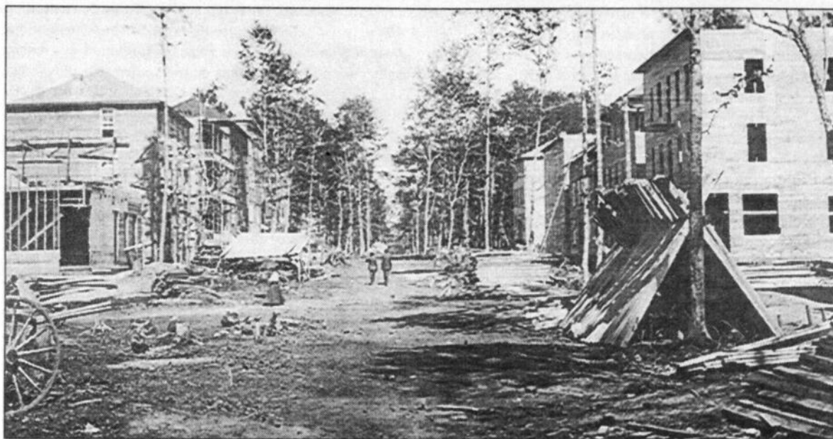
Construction de maisons à logements sur la 3e Rue à proximité de l'avenue Tamarac en 1900. Source: Cité de l'énergie
