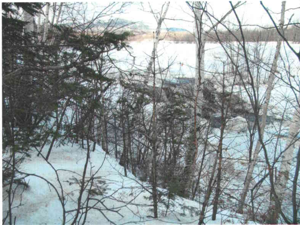
Figure 8 : Affouillement partiel observable derrière la digue fusible aval du fossé de ceinture
