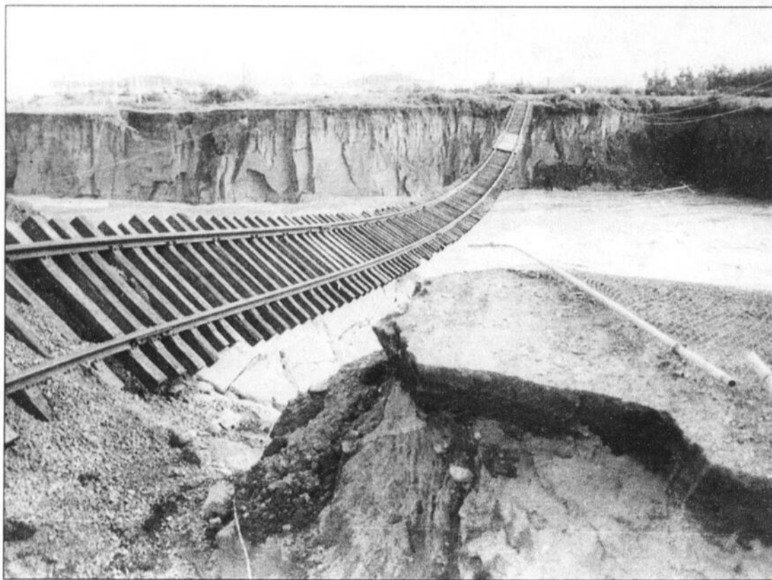
RÉSEAU FERROVIAIRE - La compagnie Alcan ne pourra compter sur le train pour s'approvisionner pendant un bon bout de temps. Notez que le rail reposait ici sur le sol, et non sur un pont, avant que les eaux se forgent un nouveau chemin de chaque côté du pont Arnaud.
