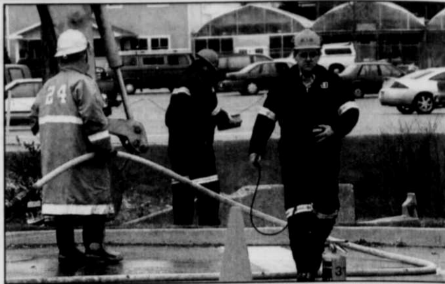
(Image-Média Mauricie: Patrick Beauchamp) La fuite de gaz est survenue lors de travaux dans le stationnement du Carrefour de Trois-Rivières-Ouest.
