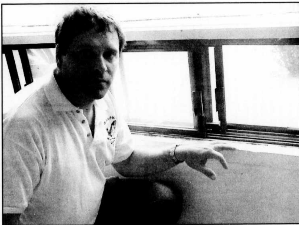
Le président du Comité consultatif des résidents, Jean Villeneuve montre la fenêtre d'un logement qui sera livré bientôt. Cette fenêtre démontre déjà des signes de détérioration importante, mais l'OMH n'a pas les moyens de la réparer. Photo: Yannick Boursier
