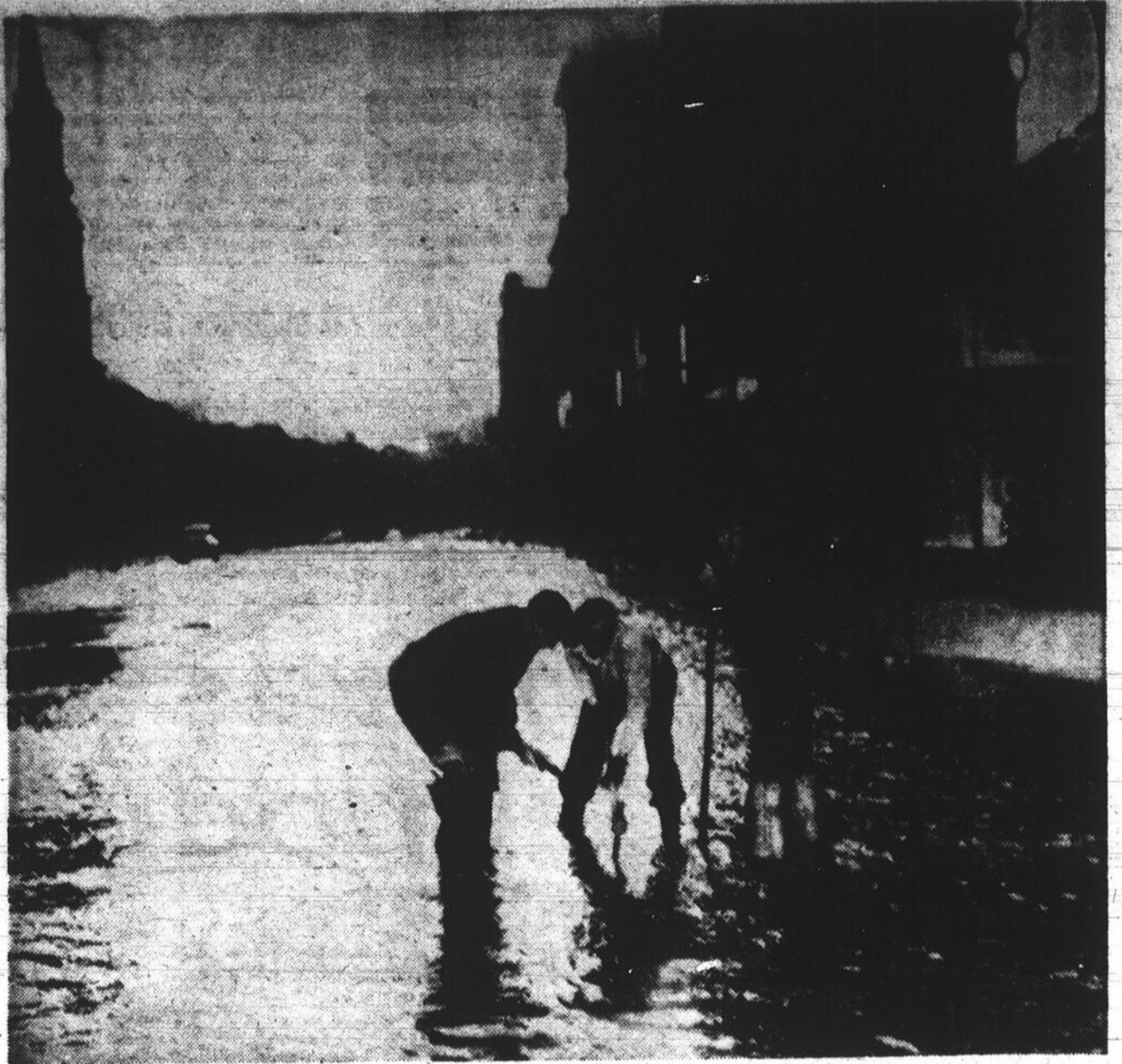
INONDATION A BOSTON — Des ouvriers effectuent des réparations, par suite du bris d'une conduite d'eau de huit pouces dans le célèbre centre d'achat "Back Bay" de Boston. Toute circulation fut interrompue, hier, pendant plusieurs heures à la suite de cet accident. (Fac-similé United Press — "Montréal-Matin")
