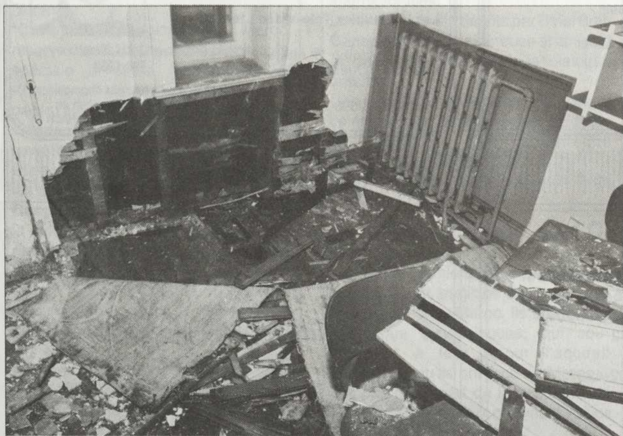
Vue partielle des dégâts causés par l'incendie dans une des classes du Talmud Torah
