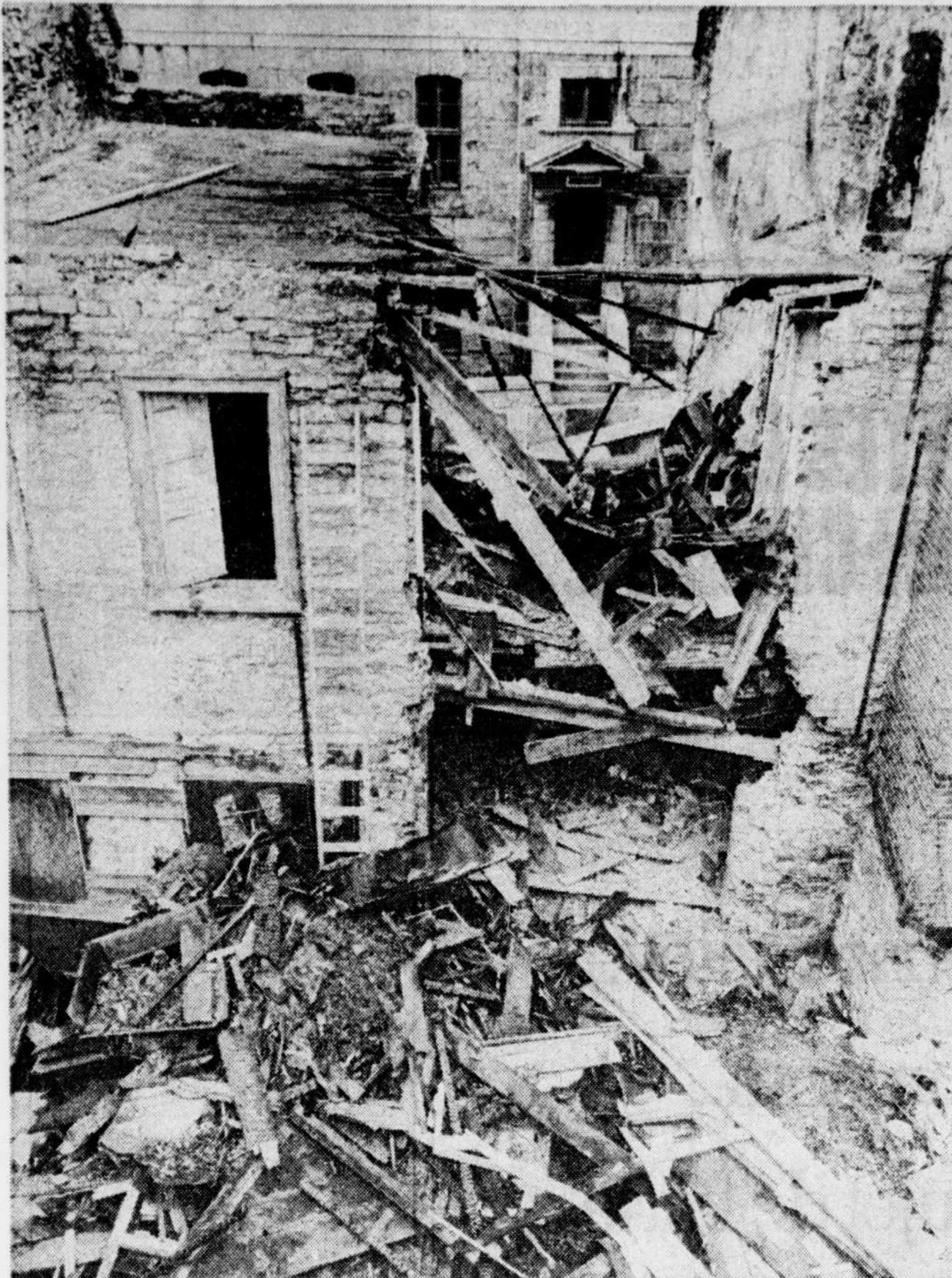
Des débris inquiétants pour les voisins jonchent la cour intérieure du 26 rue Sainte-Famille.
