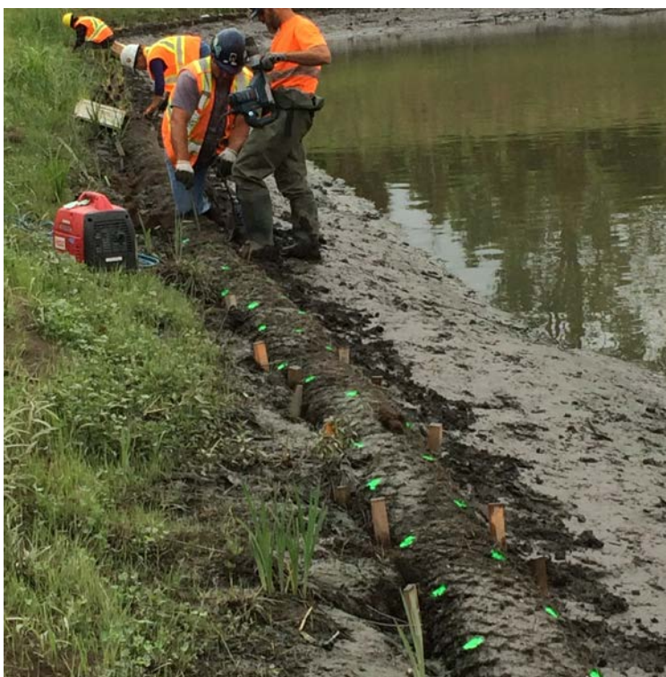
Photo 6. Installation d'une fascine prévégétalisée avec des plantes semi-aquatiques favorisant le poisson (Source : Steve Hamel).
