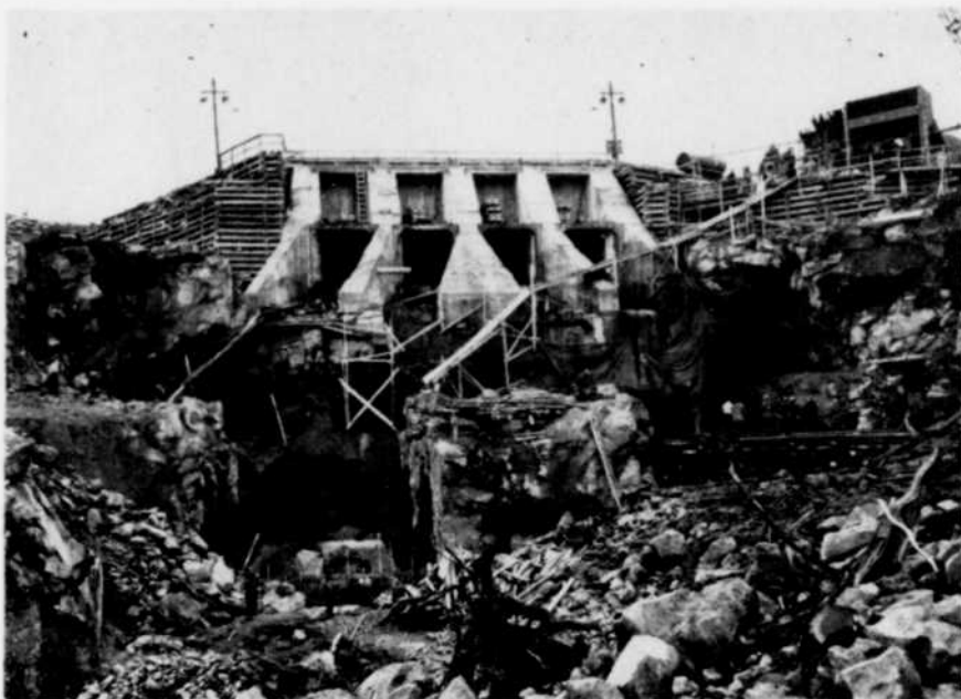
Fig. 7 — Vue de la centrale provisoire en construction, montrant l'ensemble de l'excavation et les ouvertures pour les quatre conduites forcées.
