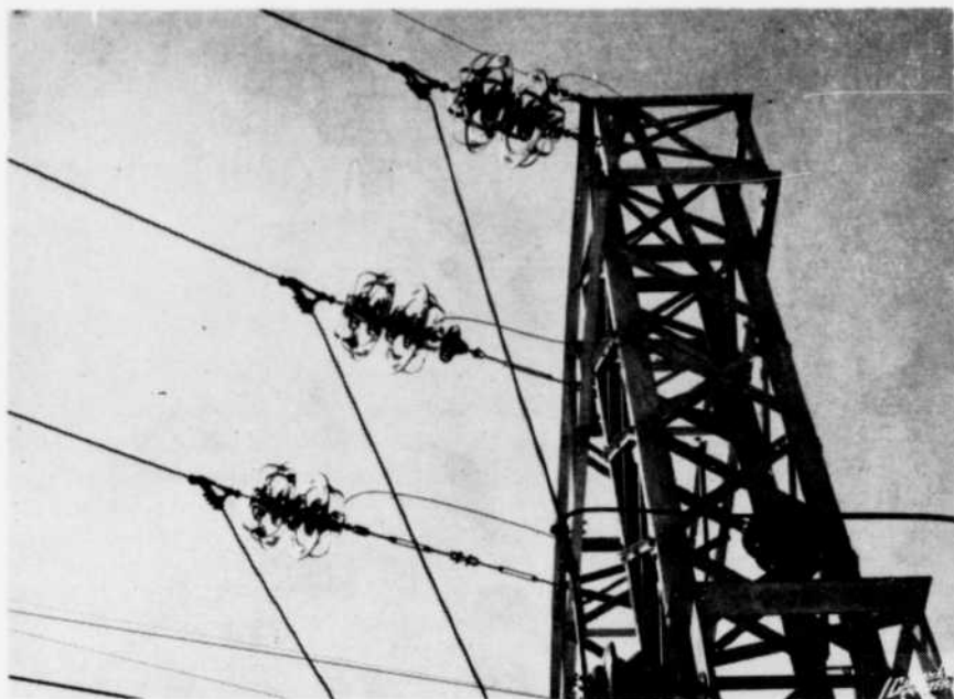
Fig. 1 — Déioniseurs d'extrémité de ligne 44 KV à Beauharnois.
