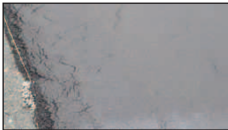
Figure 3 – Microfissures après compactage
