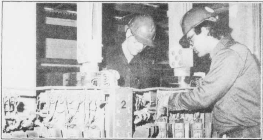
Gilles Tremblay et Chantal Lévesque s'affairent à réparer un des redresseurs en place au Complexe Jonquière. D'ici 1993, 50 appareils de ce type auront été rénovés. A lire en page 10
