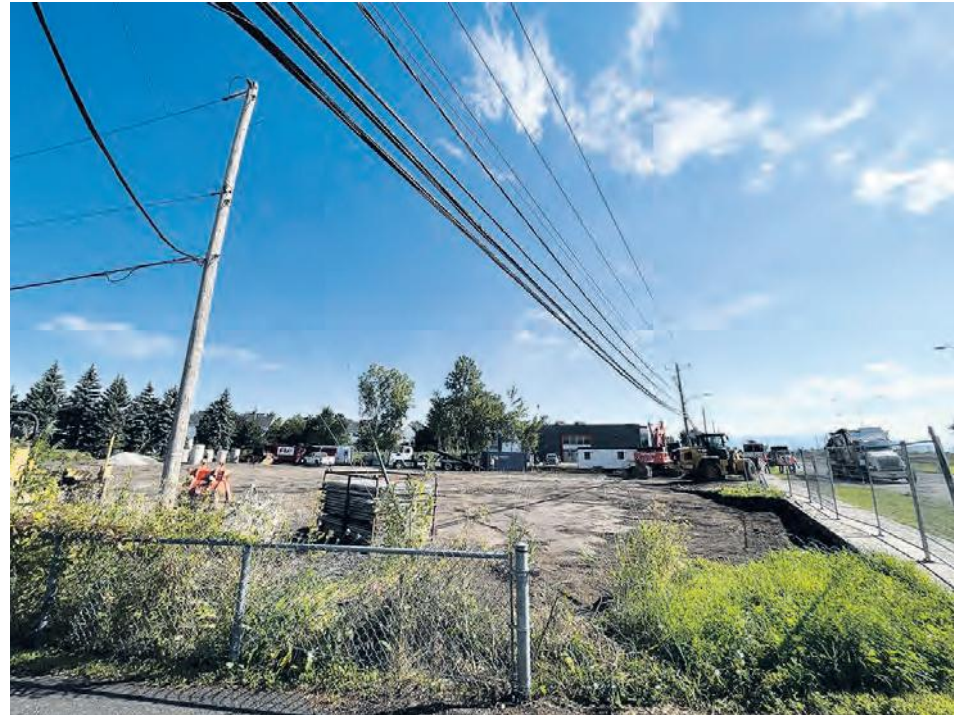
Il s'agit de travaux de raccordement d'aqueduc à un commerce qui nécessiteront la fermeture partielle de la route 116. (Photo : Frank Jr Rodi)
