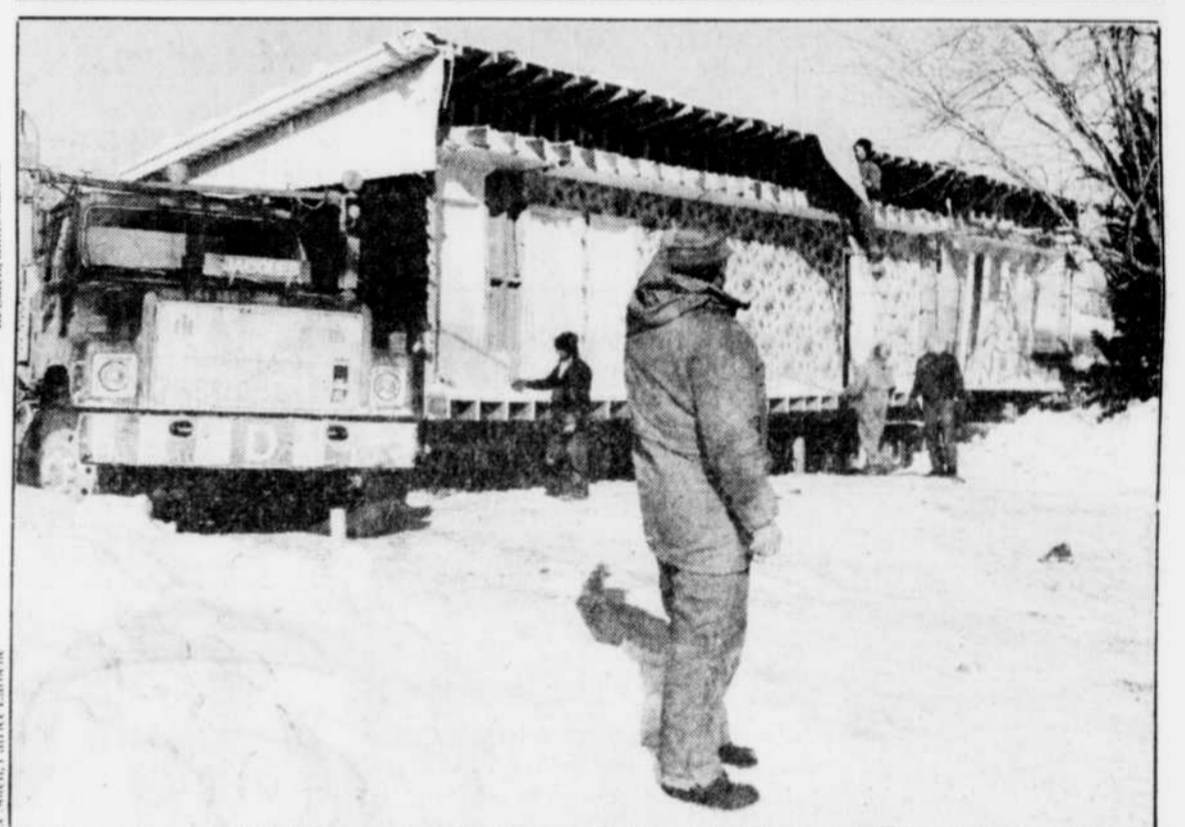
Cette maison devait être démantelée de Sainte-Foy. Le propriétaire en a donc confié la tâche à un constructeur qui l'a fait scier en deux. Puis il a engagé un transporteur de Bernières, pour que les moitiés soient installées sur un autre solage, à Saint-Rédempteur. Et tout ça entre Noël et le jour de l'An, par un mercure de -22° Celsius. Il fallait le faire !
