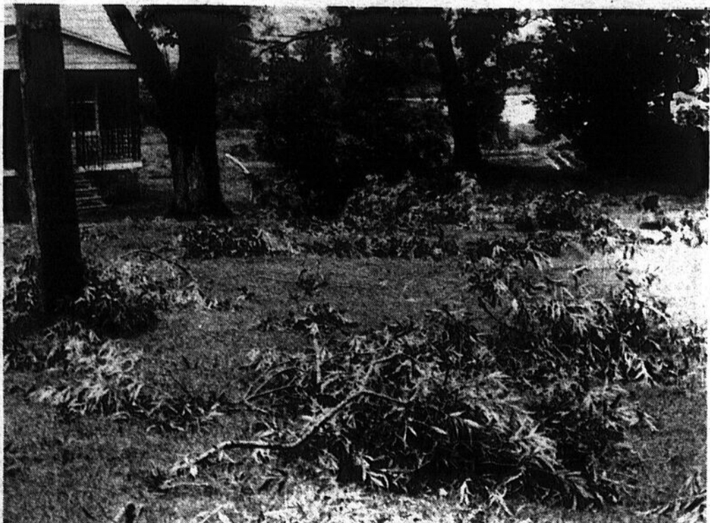
La pelouse de la résidence de M. Marie-Louise Dulac présentait cette allure après le passage des fortes bourrasques de vent. Là aussi, plusieurs arbres ont été cassés, perdant plusieurs de leurs branches.
