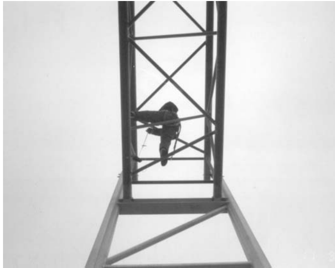
Photographie 5.6-20 Anomalie du support en treillis
