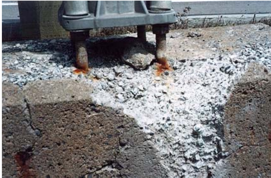
Photographie 5.4-2 Évaluation du comportement des tiges d'ancrage
