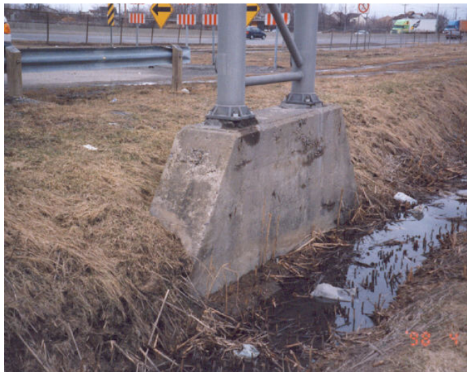
Photographie 5.3-10 Anomalie relative au remblai
