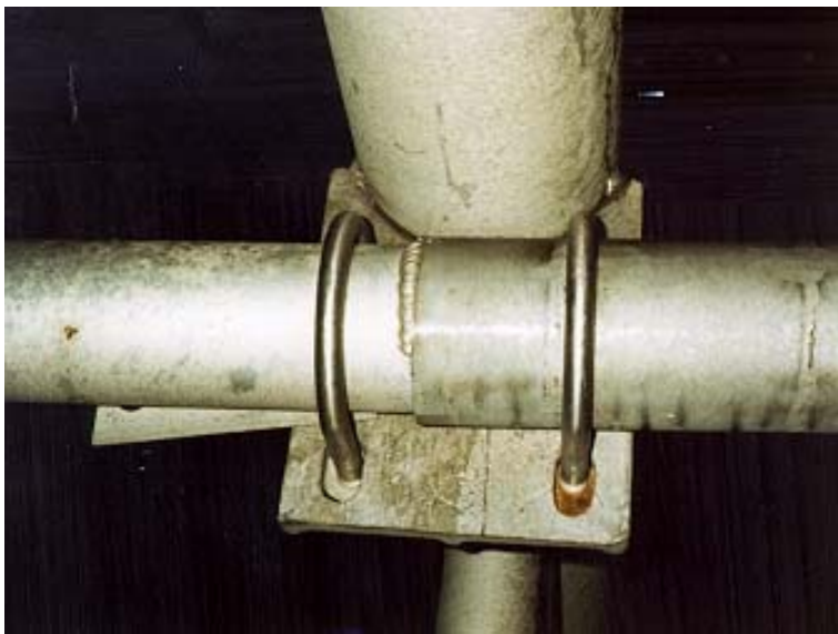
Photographie 5.6-15 Anomalie des longerons d'un support en treillis
