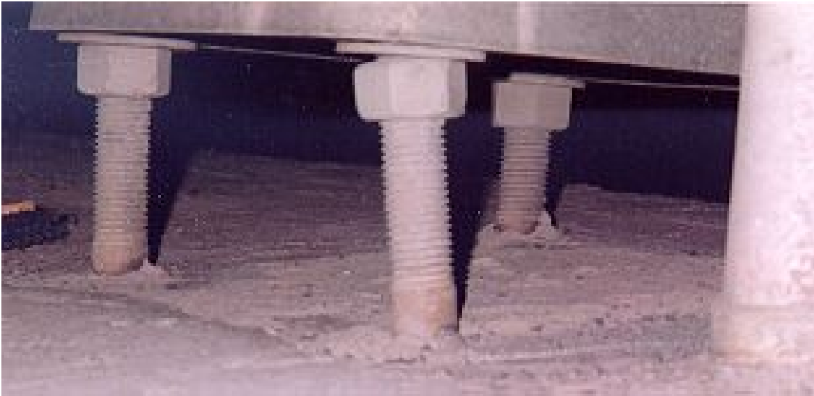
Photographie 5.4-19 Anomalie des tiges d'ancrage
