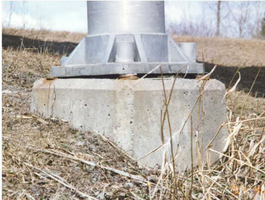
Photographie 5.4-18 Anomalie des tiges d'ancrage
