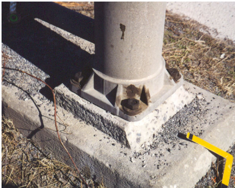
Photographie 5.4-23 Anomalie de la semelle d'ancrage
