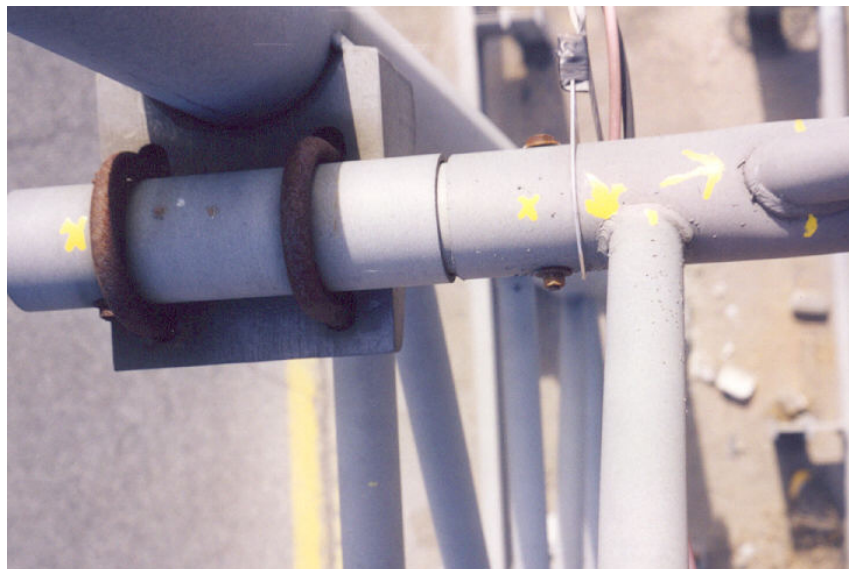
Photographie 5.6-16 Anomalie des longerons d'un support en treillis
