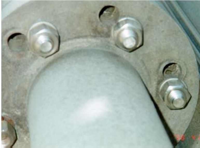
Photographie 5.8-6 Anomalie des assemblages boulonnés
