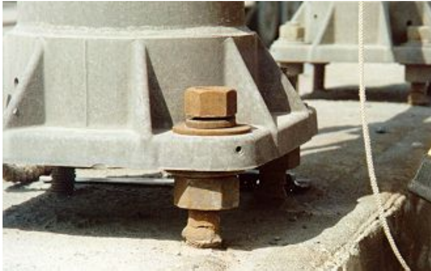
Photographie 5.4-21 Anomalie des tiges d'ancrage
