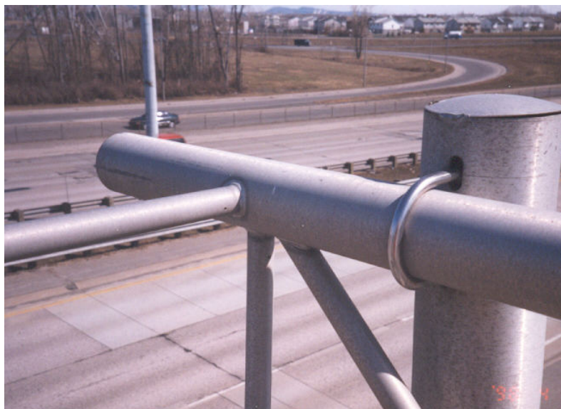
Photographie 5.6-19 Anomalie du support en treillis
