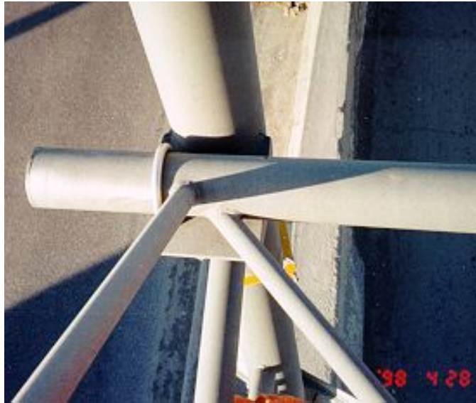
Photographie 5.9-6 Évaluation du comportement des éléments d'appui et d'assemblage du support horizontal
