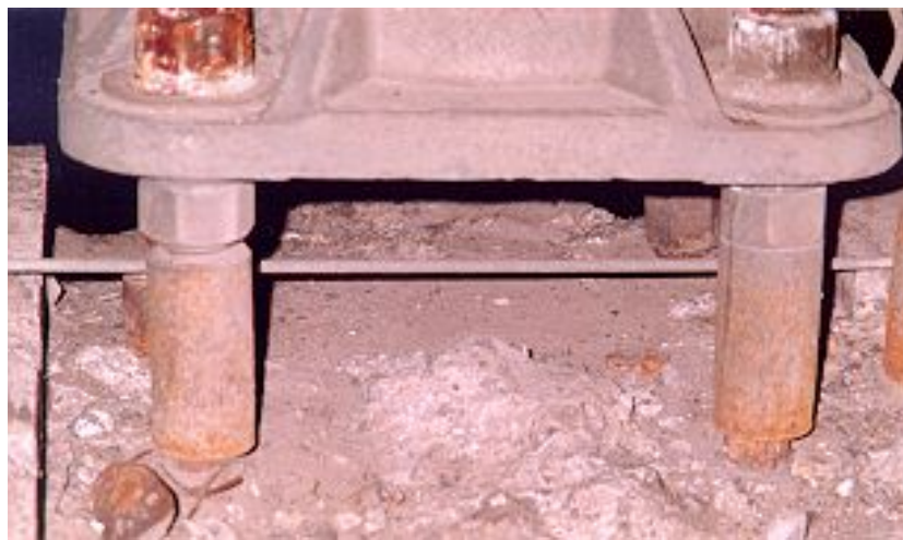
Photographie 5.4-20 Anomalie des tiges d'ancrage
