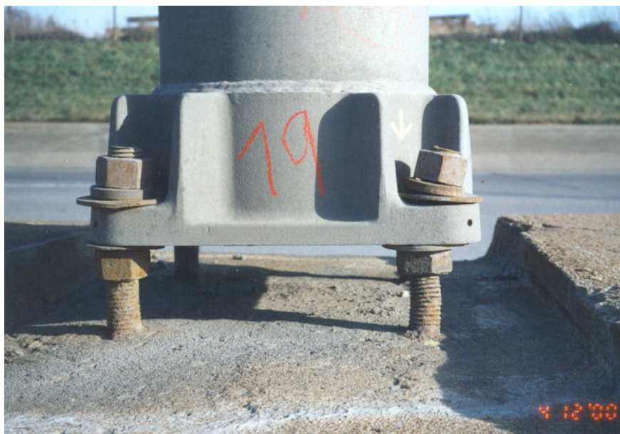
Photographie 5.4-17 Anomalie des tiges d'ancrage
