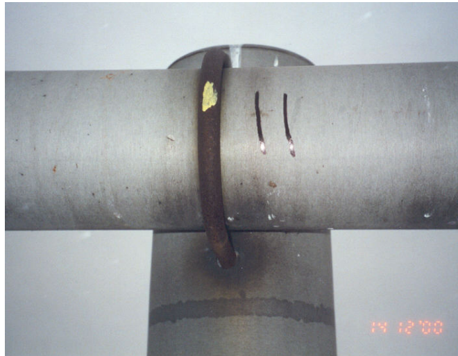
Photographie 5.9-5 Évaluation du comportement des éléments d'appui et d'assemblage du support horizontal
