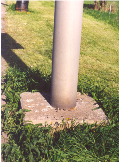
Photographie 5.4-15 Anomalie des tiges d'ancrage
