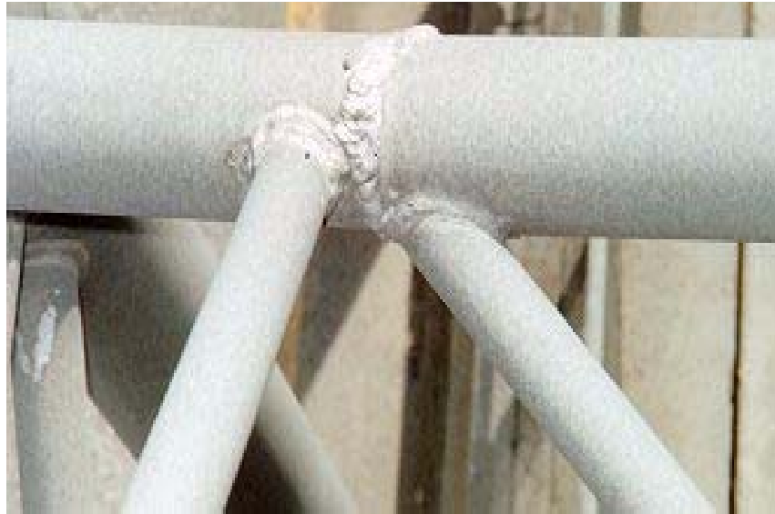
Photographie 5.6-17 Anomalie des longerons d'un support en treillis
