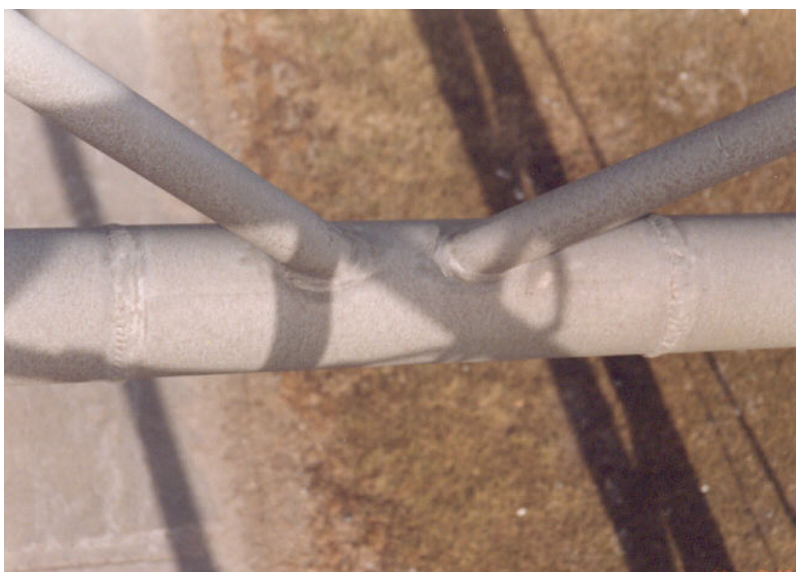
Photographie 5.6-16 Anomalie des longerons d'un support en treillis
