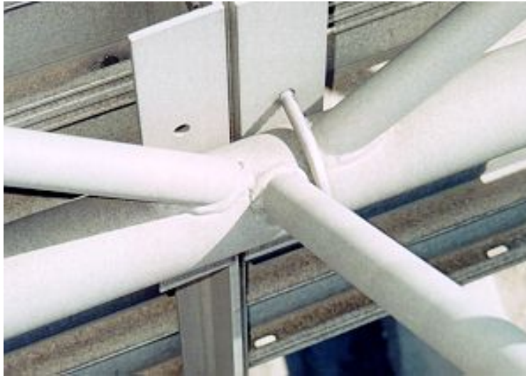
Photographie 5.10-13 Anomalie des attaches
