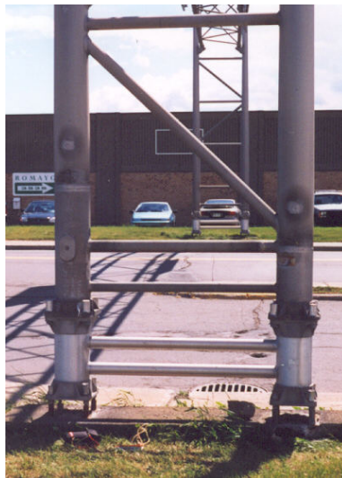
Photographie 5.5-11 Anomalie du support vertical
