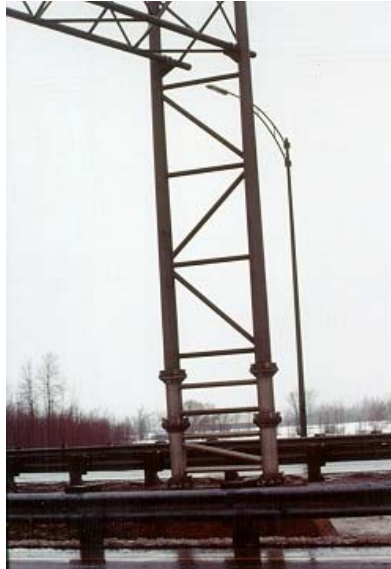
Photographie 5.5-10 Anomalie du support vertical
