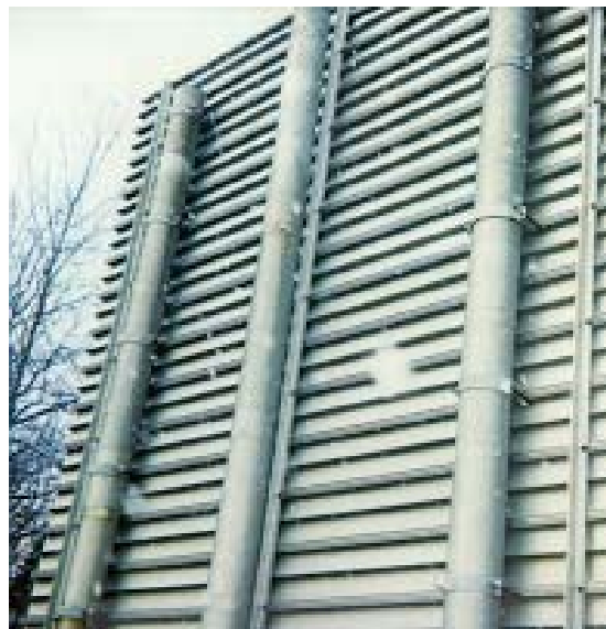
Photographie 5.10-12 Anomalie des attaches
