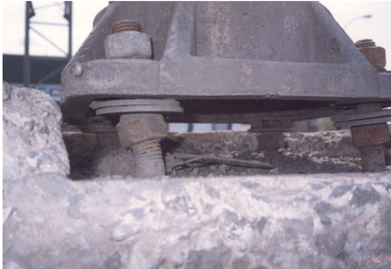
Photographie 5.4-16 Anomalie des tiges d'ancrage
