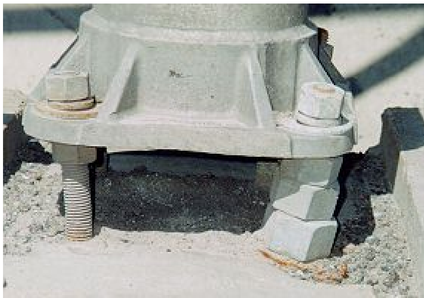
Photographie 5.4-22 Anomalie des tiges d'ancrage
