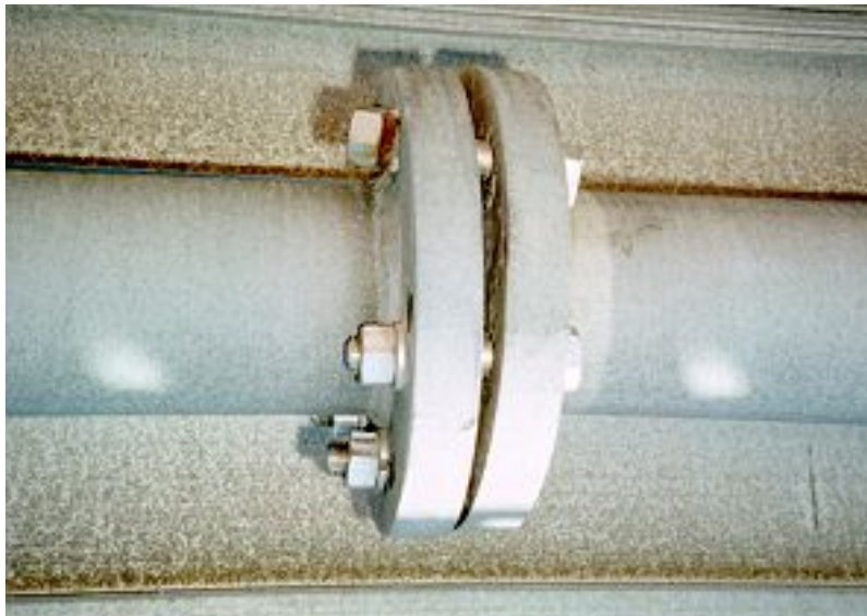
Photographie 5.8-5 Anomalie des assemblages boulonnés
