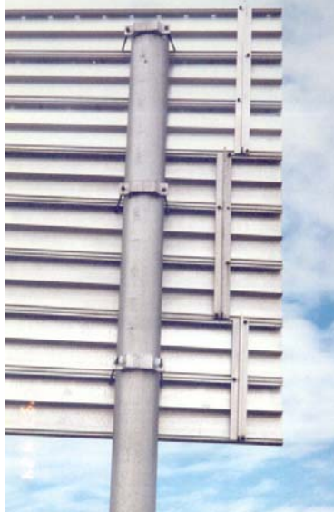
Photographie 5.10-11 Anomalie de la pièce en T
