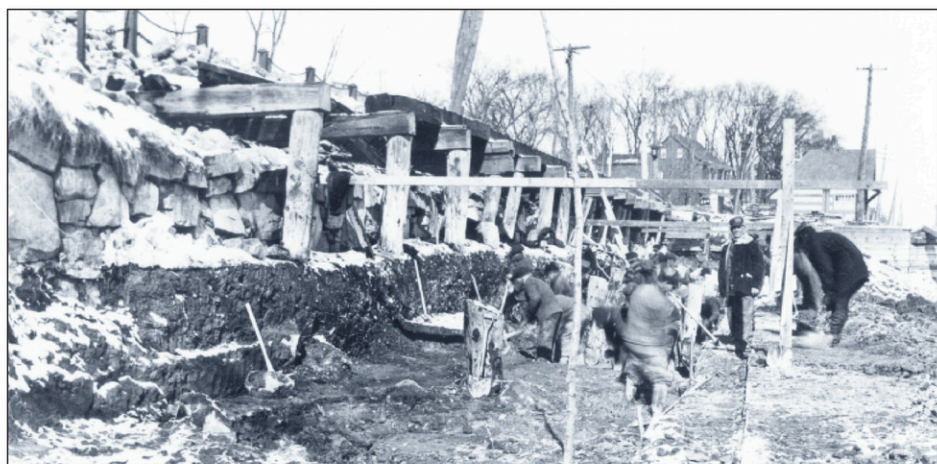
Travaux de construction du «cribwork de 1930» en amont de l'écluse n°9 du canal de Chambly. Ces travaux ont entraîné la démolition de l'entrepôt et du quai de la Singer. La photo montre le mur de soutènement en pierres sèches et l'un des rangs de pieux du quai.
