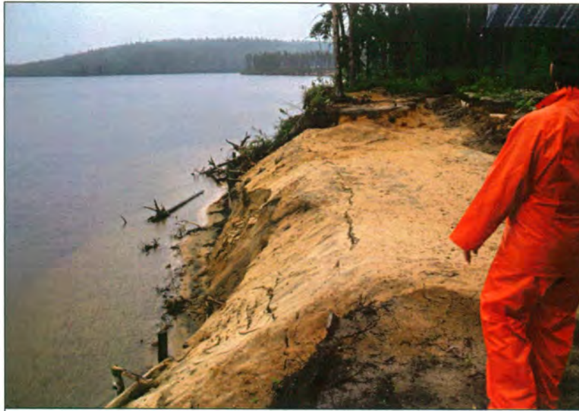
9- Fissure de tension au sommet du talus
