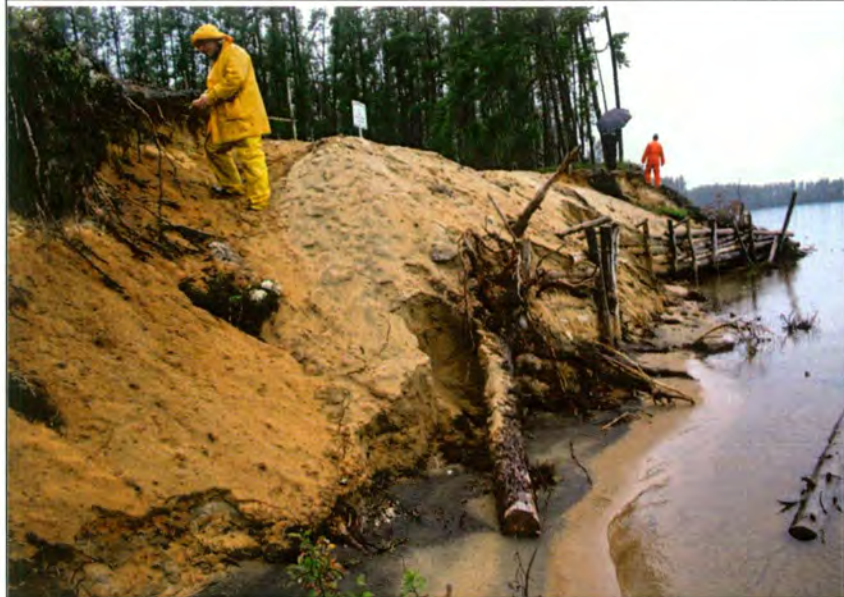
17-Matériaux sableux rejetés sur le talus et mur de soutènement en troncs d'arbres devant le site
