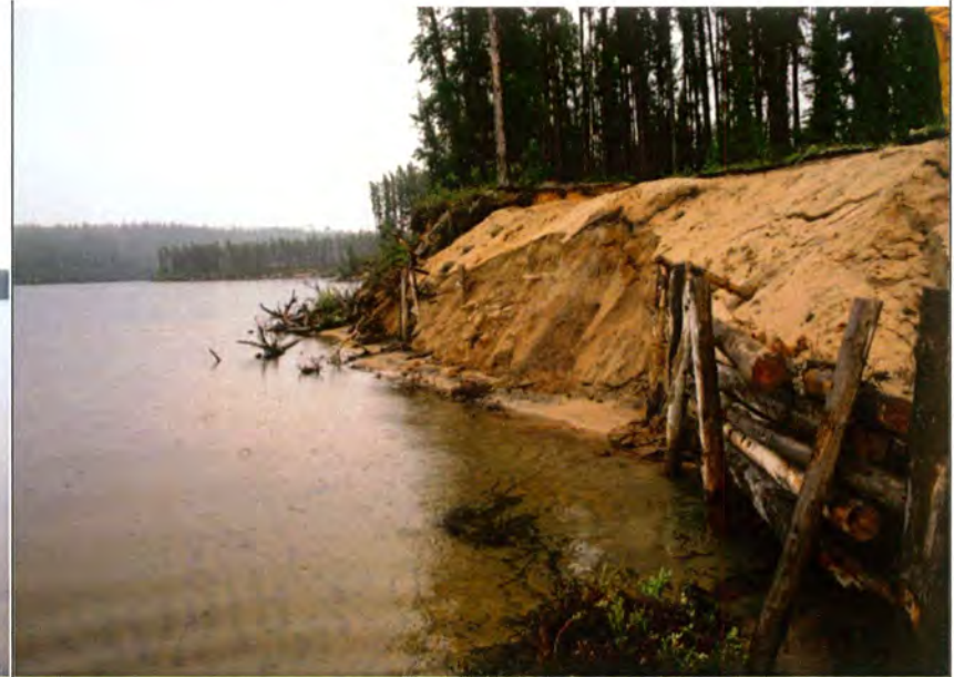
16-Matériaux sableux rejetés sur le talus et mur de soutènement en troncs d'arbres devant le site
