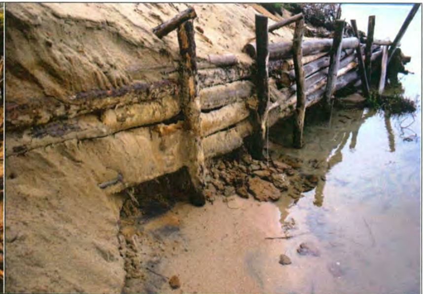
20-Mur de soutènement en troncs d'arbres; sapement évident à la base du mur
