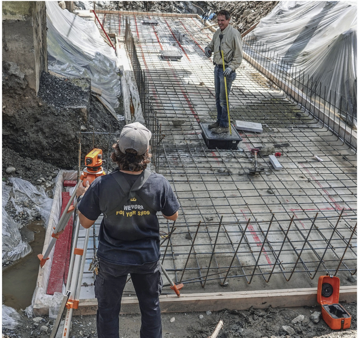
Nicolas Léger-Loiselle (en bas) et Luc Boulanger (en haut) lors des travaux d'installation d'un nouveau tapis d'embarquement au télésiège IV.
