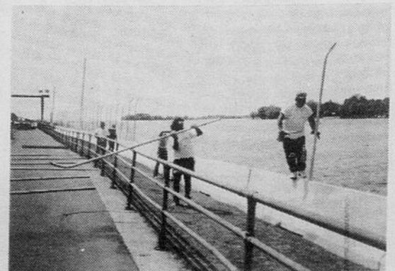
Plusieurs personnes s'affairent à l'installation de la nouvelle clôture qui longera la berge aux endroits les plus périlleux pour les milliers de spectateurs qui assisteront cette année à la 54e édition des régates de Valleyfield.
