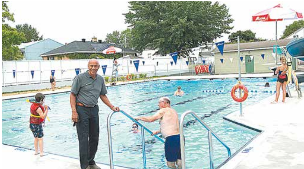
Le président de l'Arrondissement de Beauport et conseiller municipal du district « de la Chute-Montmorency-Seigneurial », Stevens Mélançon, est fier des travaux de rénovation majeure réalisés au coût de 1, 2 M$ à la piscine de Courville. (Photo : Michel Bédard)
