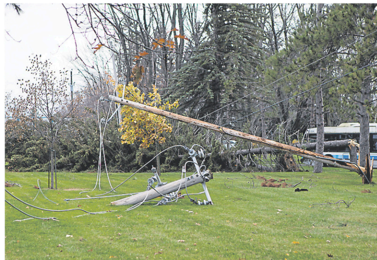
Plusieurs poteaux ont été entraînés au sol par la chute d'un arbre sur le terrain de l'École nationale de police de Nicolet, vendredi, coupant ainsi la ligne principale d'électricité et de télécommunications de Nicolet. — PHOTO LE NOUVELLISTE, OLIVIER CROTEAU
