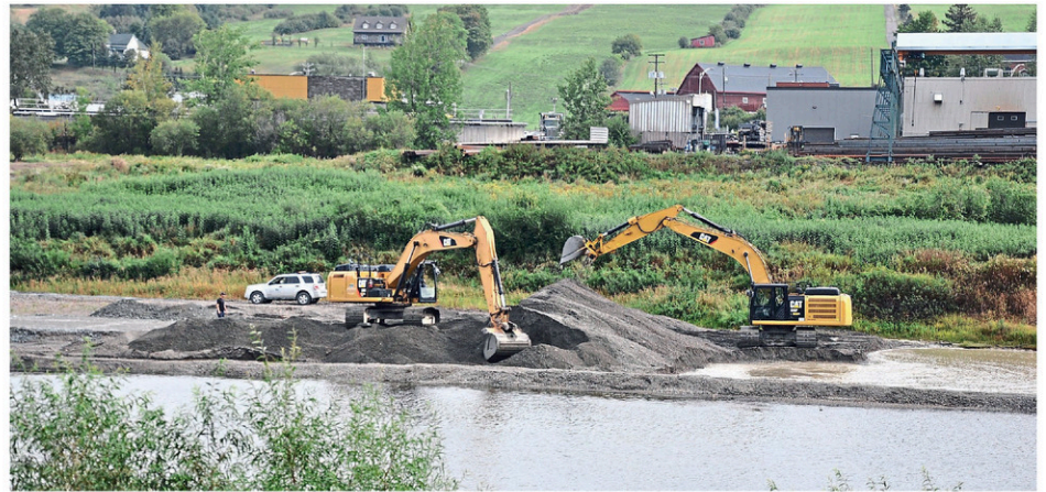
Rappelons que Beauceville a effectué des travaux dans la rivière Chaudière au début du mois de septembre afin de retirer d'anciens batardeaux. (Photo L'Éclaireur Progrès - Archives)
