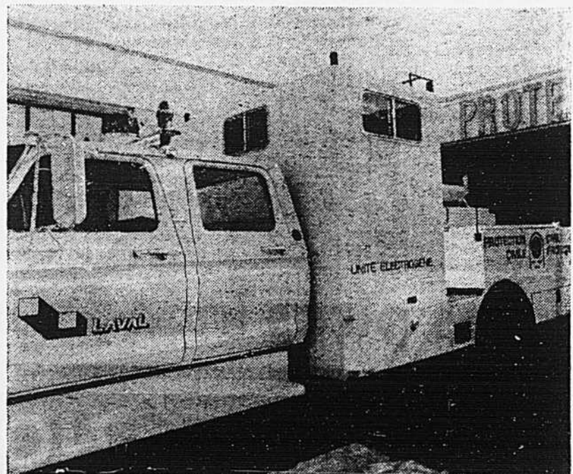
Ce camion est capable de "brancher" tout un édifice. C'est un groupe électrogène ambulante. Inutile de dire qu'il est puissant...
