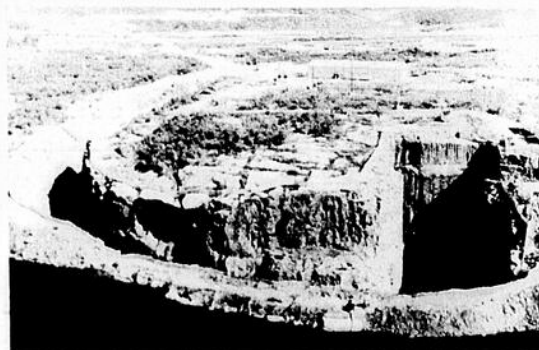
Vue de la prise d'eau d'Outardes 2, à la droite; à droite, on remarque un batardeau qui sert de dérivation et qui permet aux hommes de travailler dans des conditions secs.
