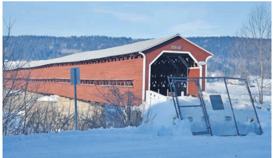
La municipalité doit faire réaliser une seconde étude afin de savoir comment régler la problématique des piliers. (Photo L'Éclaireur Progrès - Archives)
