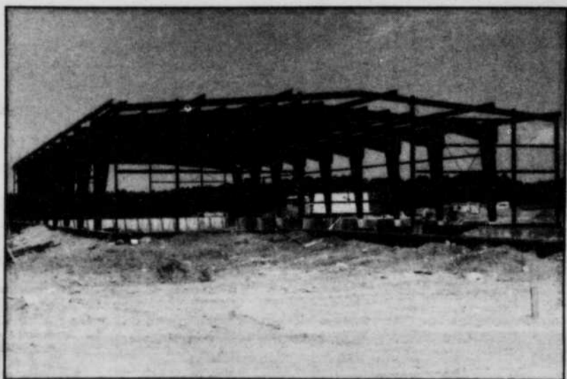
La structure de la nouvelle usine de Saint-Séverin-de-Proulxville au moment de sa reconstruction après l'incendie de février 1979.
