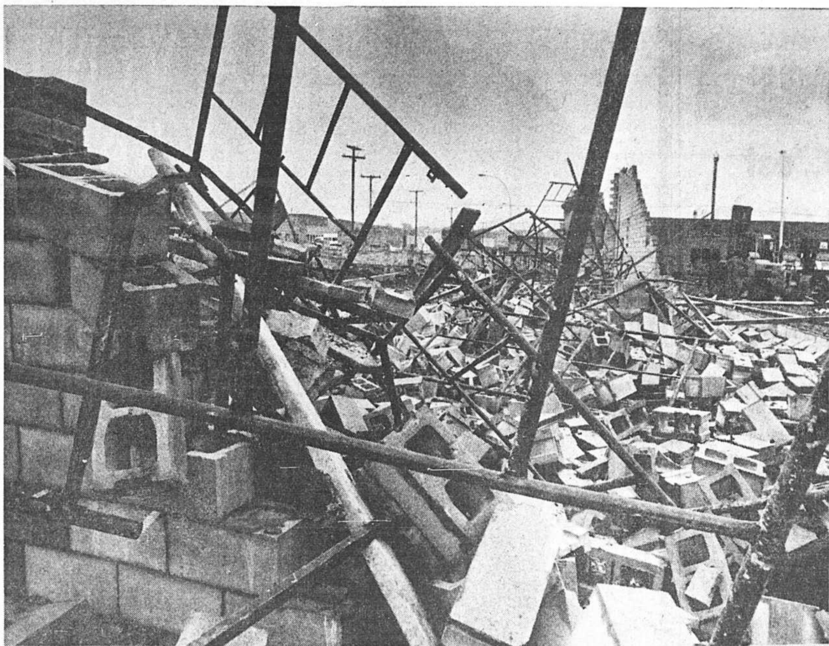
Le mur s'est soudainement désagrégé, entraînant dans sa chute un échafaudage sur lequel travaillent cinq ouvriers, dont trois ont été grièvement blessés.
