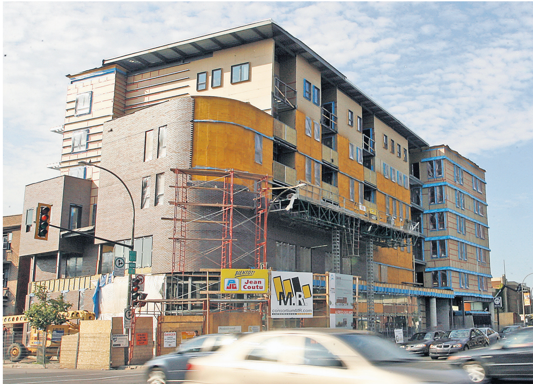
La construction de la future résidence pour personnes âgées Alfredo-Gagliardi, aux confins de la Petite Italie, va bon train. L'immeuble de quatre à six étages, construit au-dessus de la station de métro Jean-Talon, comptera 95 logements.
