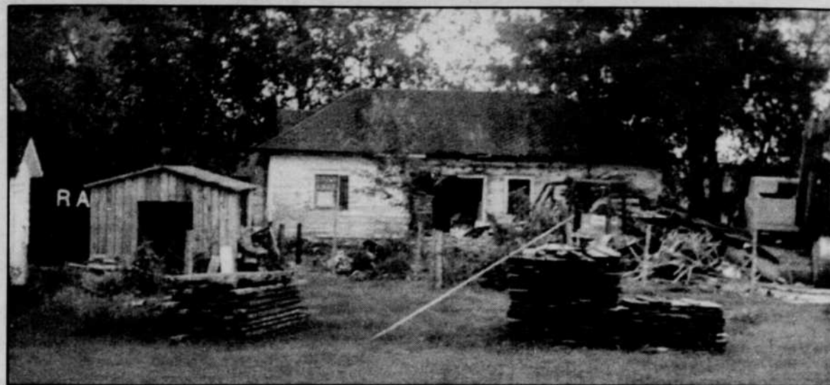
La propriété d'Irénée Desnoyers lors des travaux de nettoyage et de démolition commandés par Abercorn en 1998.
