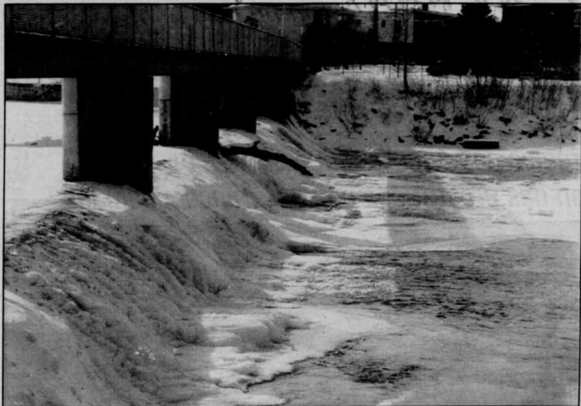
Hydro-Québec avait essayé de se débarrasser de son barrage de Farnham, l'automne dernier, mais personne n'en voulait. On apprend aujourd'hui qu'il n'est pas en parfait état. photo Michel St-Jean
