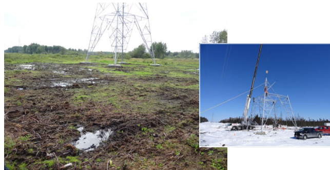
Photo A.16 : Réaménagement d'une aire de travail en milieu humide, projet de la ligne Figuery-Palmarolle
