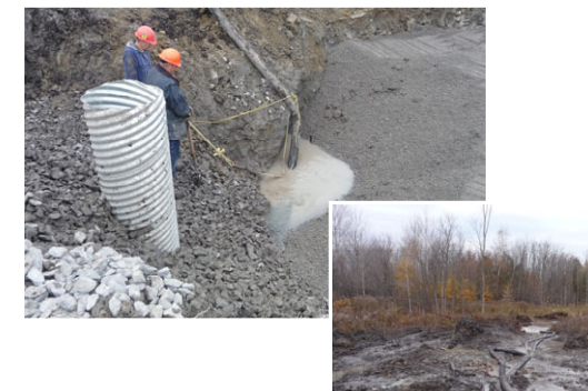
Photo G.1 : Pompage du fond de fouille et rejet dans la végétation, projet de la ligne Chénier-Outaouais
