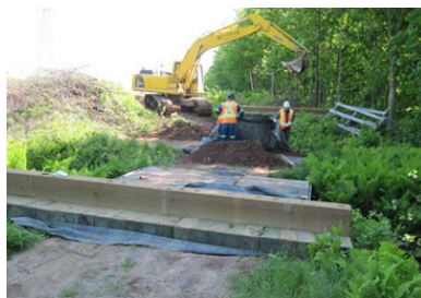
Photo B.6 : Membrane géotextile installée sous la culée d'un pont provisoire, projet de la ligne Nicolet-Bécancour
