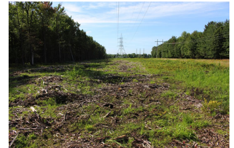
Photo A.18 : Fascines retirées à la fin des travaux sans ensemencement, projet de la ligne Saint-Césaire-Bedford
