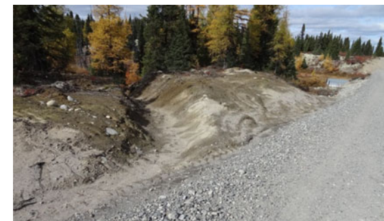
Photo F.10 : Fossé de déviation des eaux de ruissellement, projet de raccordement du complexe de la Romaine
