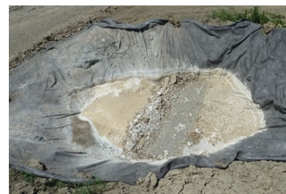
Photo G.3 : Résidus de béton asséchés au fond de la trappe à sédiments, projet de la ligne Nicolet-Bécancour
