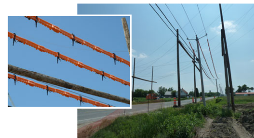
Photo H.5 : Protections aériennes et protecteurs de conducteur utilisés pour le croisement d'une ligne sous tension, projet de la ligne Nicolet-Bécancour
