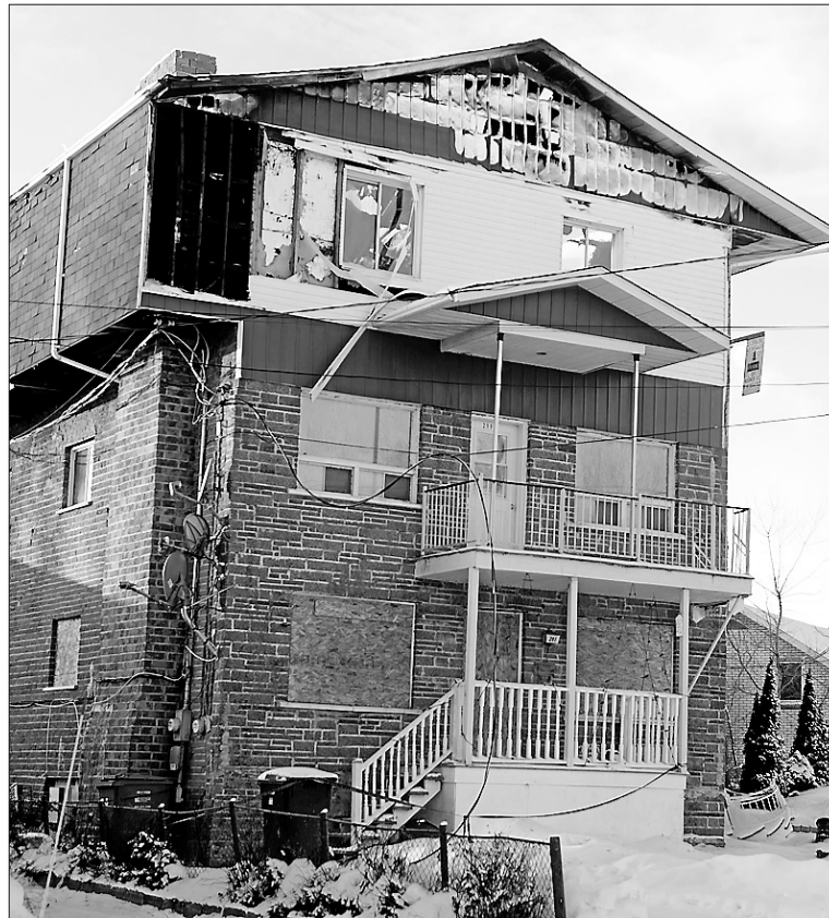
L'immeuble de 12 logements est une perte totale. — PHOTO: STÉPHANE LESSARD
