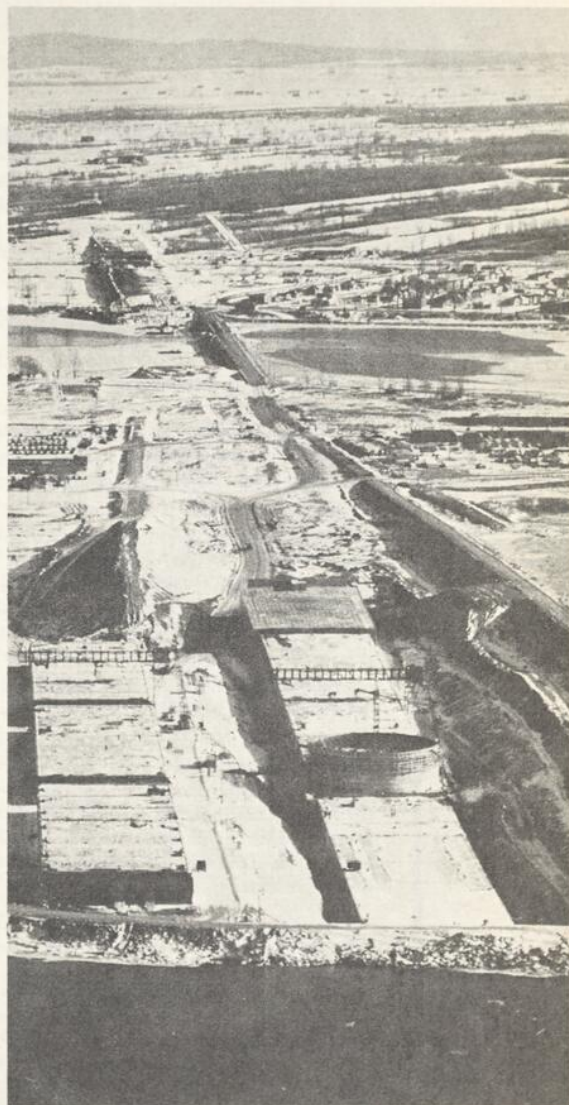
La rotonde que l'on aperçoit dans la partie droite de la photo est destinée à être une tour de contrôle dans laquelle logeront les préposés à l'entretien et au contrôle de la circulation dans le tunnel. Il y en aura deux, une à chaque extrémité du parcours.
