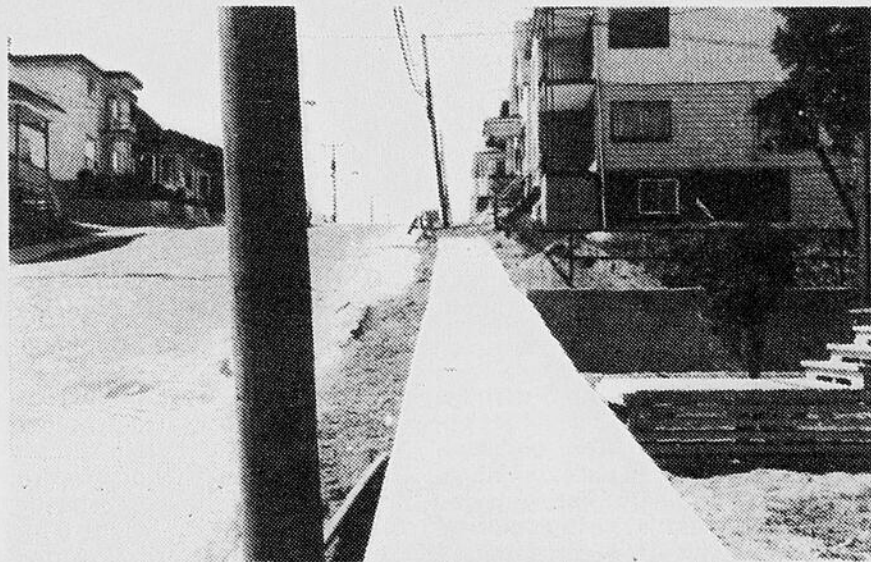
MAUVAIS ETAT — Suite à de nombreuses plaintes, la ville de Chicoutimi a décidé de reconstruire une section de trottoir du boulevard Saint-Paul.
