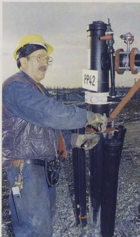
On vérifie régulièrement les puits de captage du biogaz.
