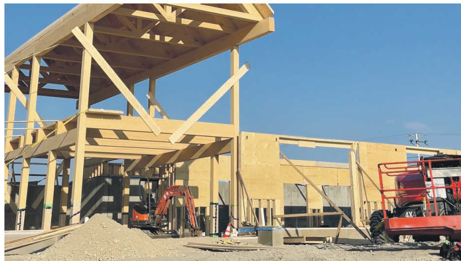
La construction du bâtiment municipal multifonctionnel est déjà bien amorcée à l'île d'Anticosti. Photo courtoisie
