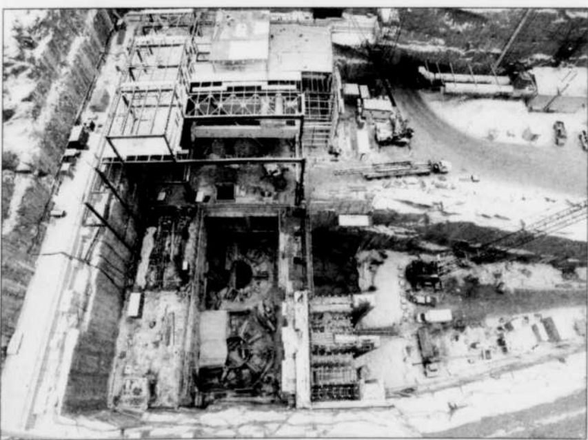
La centrale de Toulmoustou produira 526 mégawatts et coûtera 800 millions $.
