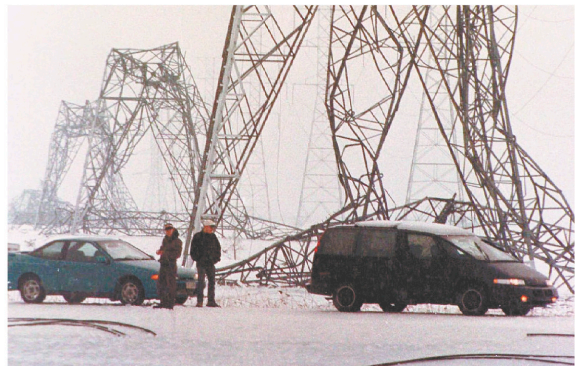
Des automobilistes observent des pylônes endommagés près de Saint-Bruno-de-Montarville.
