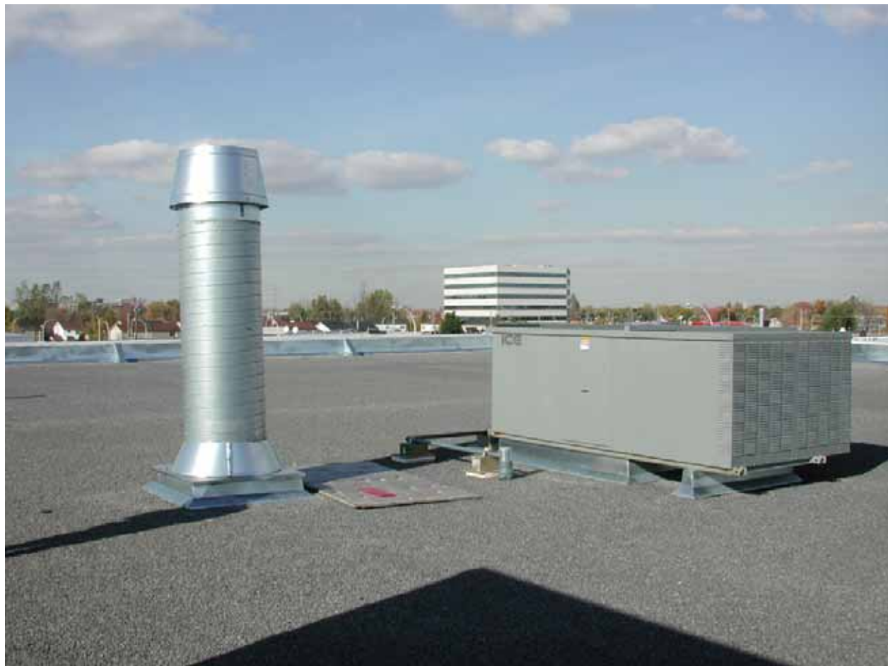
Photo 4a : Proximité de la cheminée d'évacuation relativement à l'unité d'air de remplacement
