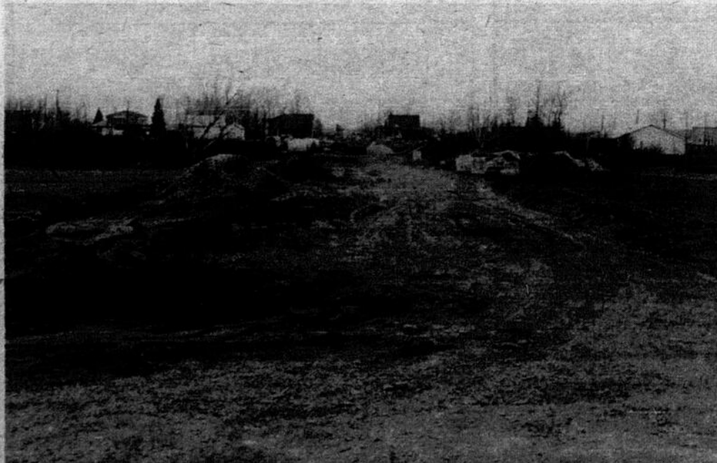
Les travaux de construction du nouveau tronçon de la rue Vallée à Plessisville seront complétés d'ici décembre. (Photo L'Union)
