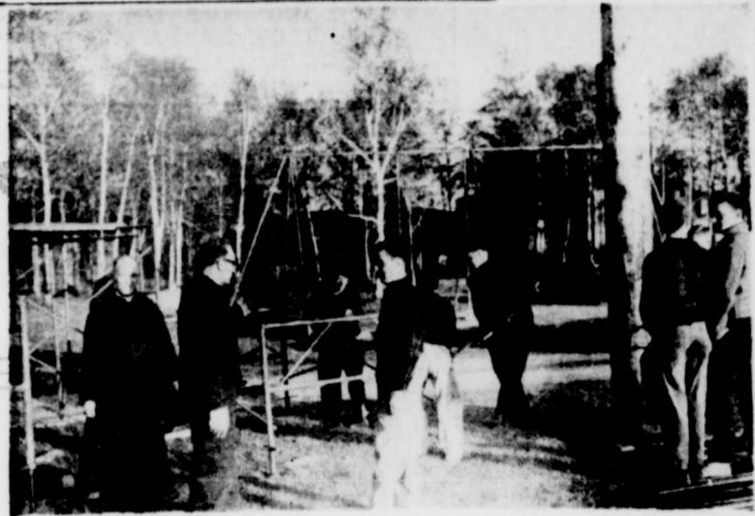
DES TRAVAILLEURS BENEVOLES ont entrepris lundi soir la construction du reposoir du congrès Eucharistique de Grand'Mère qui se déroulera les 11, 12, 13 et 14 juin prochain. Nous voyons ici un groupe de bénévoles travaillant sous la direction de M. le chanoine Hervé Matteau, président du congrès, et de M. Robert Marcouiller, président du comité du reposoir.
