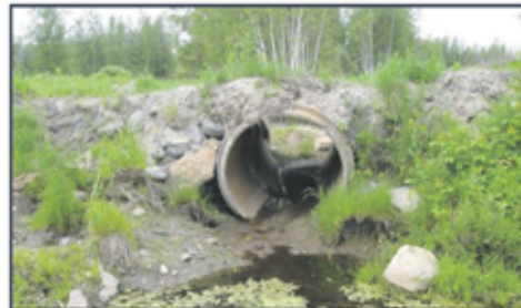
Des aménagements mal conçus peuvent avoir des impacts importants sur un cours d'eau
