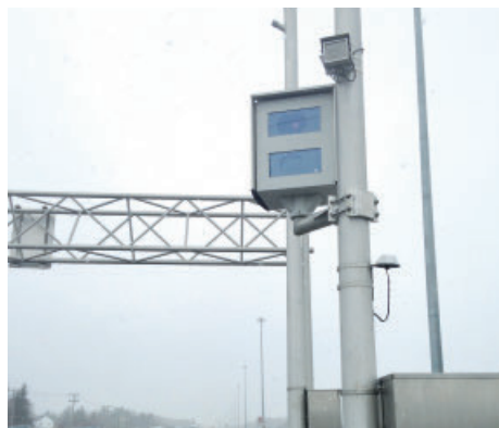
Photo Christian Asselin Ralentissez à l'approche de ce radar, installé le 14 juillet 2016 sur l'autoroute 15 Sud à la hauteur du kilomètre 24.
